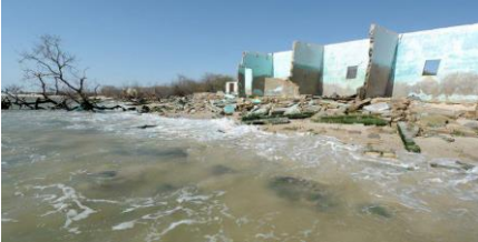
La montée des eaux : conséquence du risque climatique
